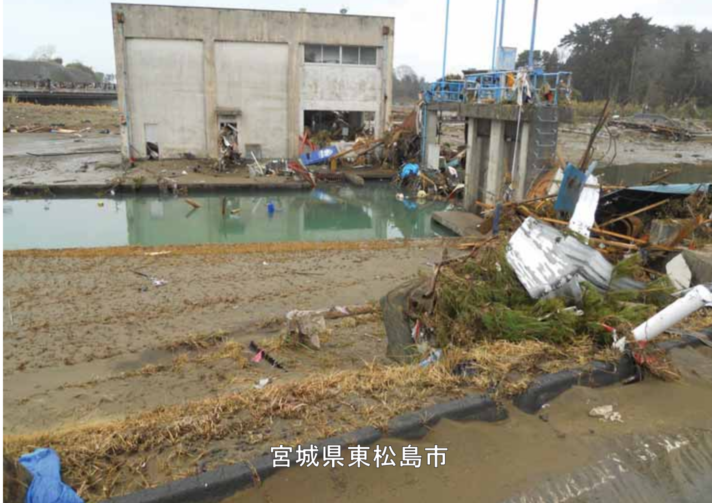
0201_2_018_018711_東松島市_2011.3.15_東名運河_新町_立石排水機場
